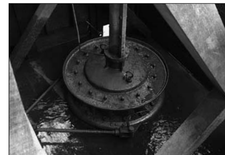
Abb. 5: Die Francis-Turbine des Mühlenmuseums Moissburg Foto Archiv FLMK
